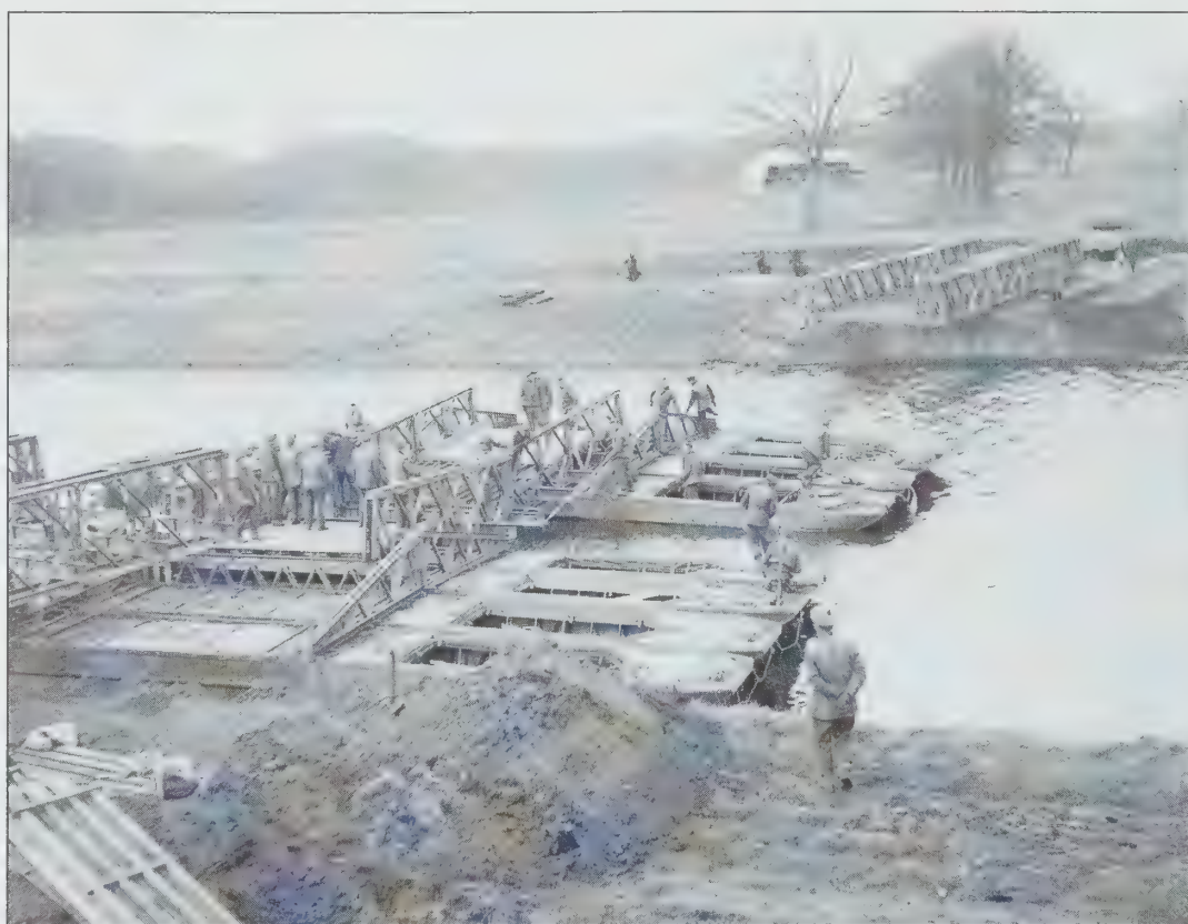
DE GENIE VAN DE VIERDE DIVISIE WERKT AAN EEN BAILEYBRUG OVER HET TWENTEKANAAL BIJ DELDEN. (OPENBARE ARCHIEVEN CANADA 49159)
